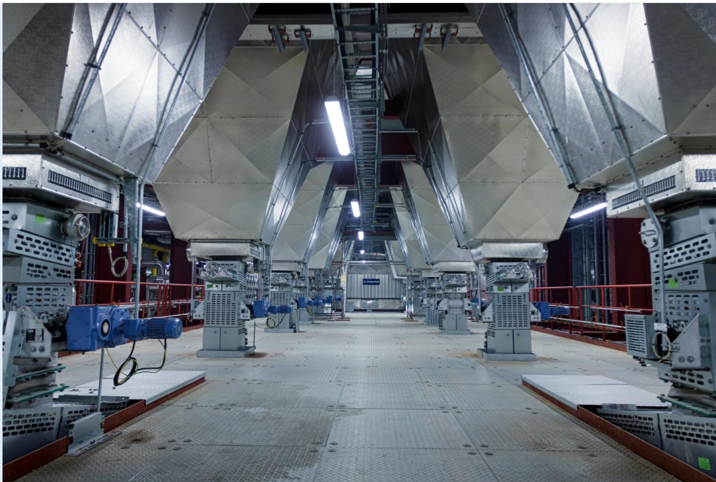
Kesseltrichter im Müllheizkraftwerk Magdeburg-Rothensee, mit freundlicher Genehmigung der MARTIN GmbH für Umwelt- und Energietechnik.
